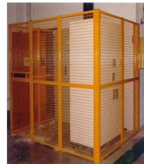
Figure V.5 : Utilisation d'obstacle : grillage (protection collective)
