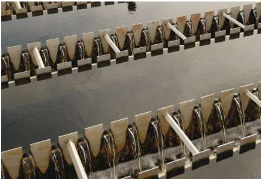
Figure 4.6. Décanteur physico-chimique à recirculation de boues externes.
