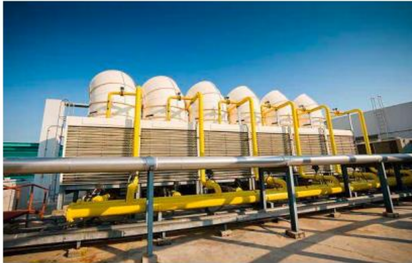
Figure V.1. Photo réelle de tour de refroidissement
