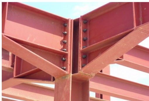
Figure 69: Assemblages rigides dans les deux directions par platines d'extrémités avec dispositif d'éclisse soudée
