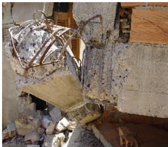
Fig. 3. 16 : Défaut de ferrailage
