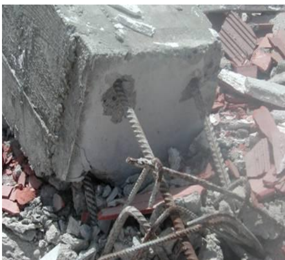
Fig. 3. 18 : Ségrégation des bétons
