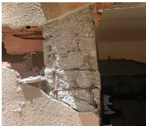
Fig. 3. 19: Mauvaise reprise de bétonnage
