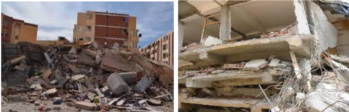
Fig.3. 1 : Effondrement des structures après séisme de Boumerdes 23-05-2003
