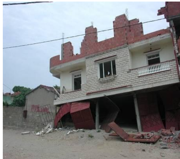
Fig. 3. 17 : Défaut de réalisation
