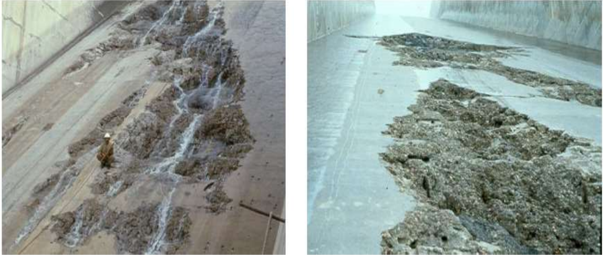
Figure V.2 : Photos illustrant des dégâts dus à la cavitation sur des coursiers lisses
